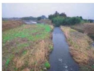
河床に土砂が堆積し断面を阻害
